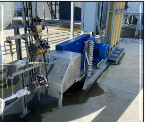
O2 cold end fire shield
